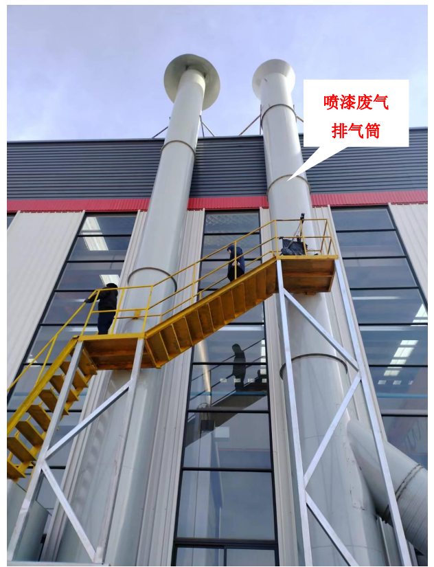
喷漆废气排气筒 DA003
